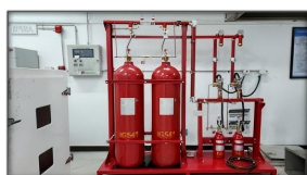
建筑消防实习实训基地 (气体灭火系统)
