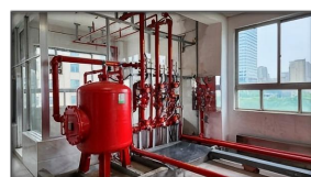
建筑消防实习实训基地 (自动喷水灭火系统)
