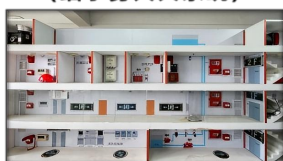
建筑消防实习实训基地 (自动报警与联动控制系统)
